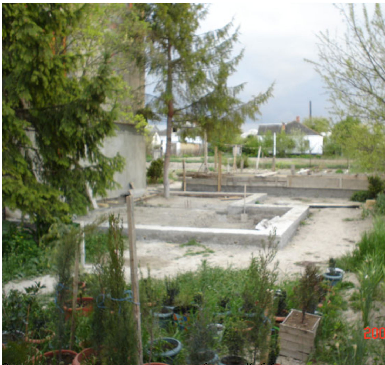
Фондамент в виде ступенчатой конструкции, когда по мере строительства вводится опалубка и обрешетка
